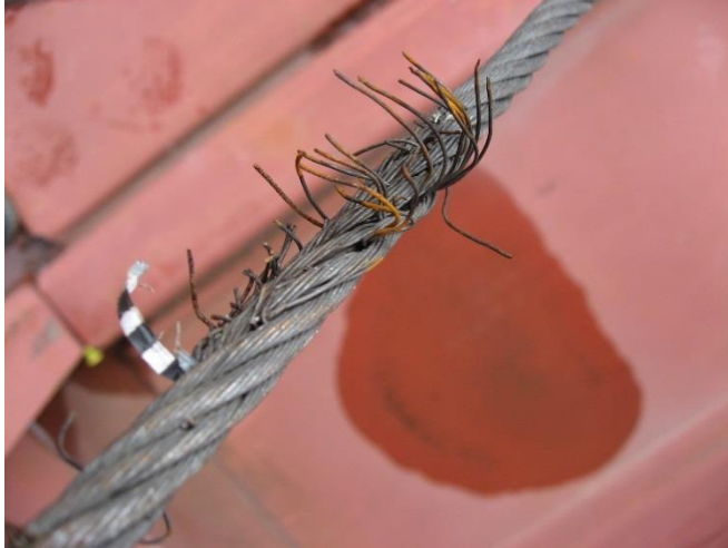
b) Câble brisé
